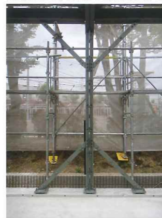
東日本大震災、職人不足により、建築費が高騰している中、専門職を必要としない構造体を考えるようになった
