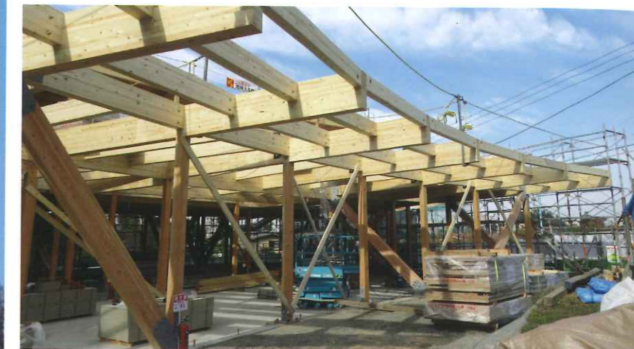
木造で、扇型の形とすると、難易度は急に高くなった。ジョイントの設計にエネルギーが費やされた。ただ、屋根の傾斜が緩いため、屋根の銅板は扇型にせずに済んだのが幸いだった。
