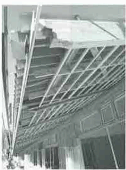
「キーラムメガビーム」により、12.6mのロングスパンを飛ばすことができた
